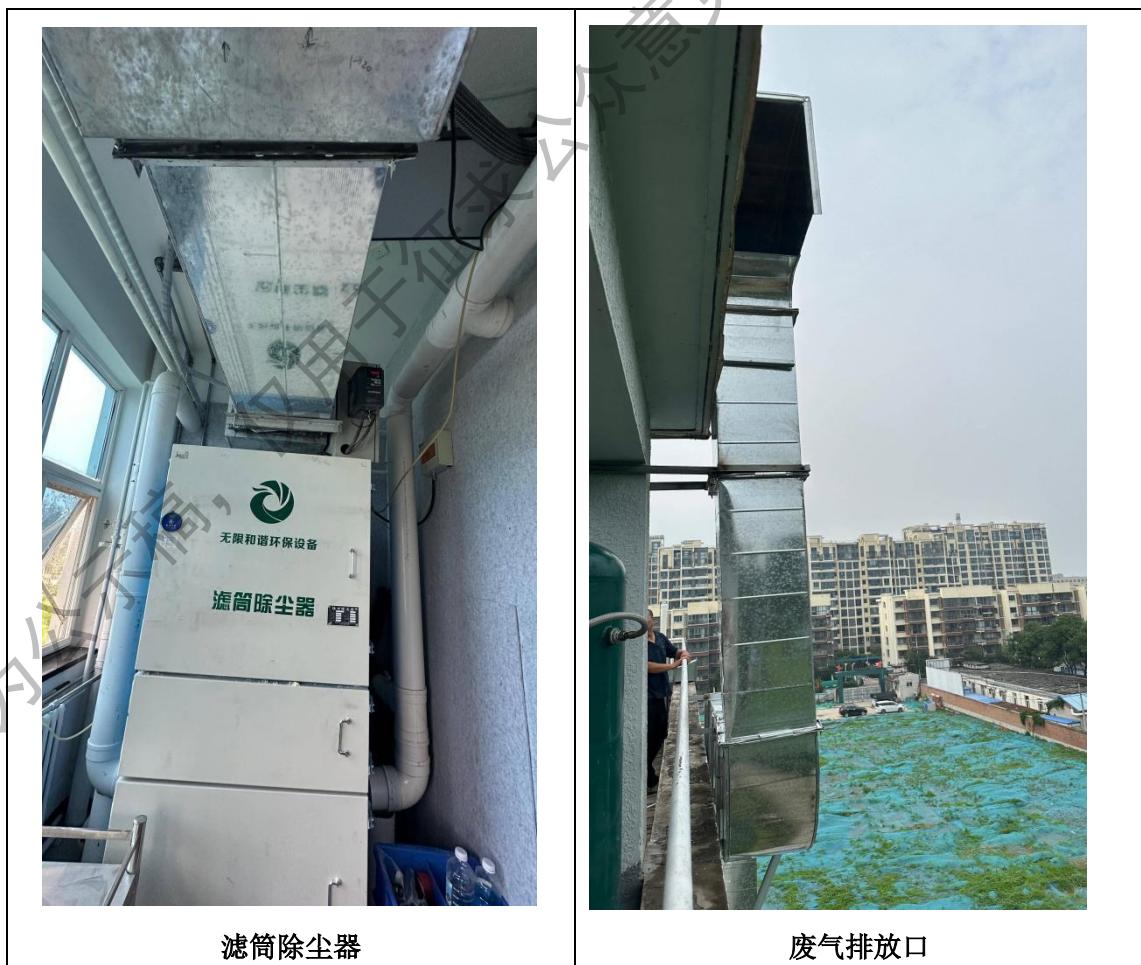
图 4-2 废气处理设施及排放口照片
