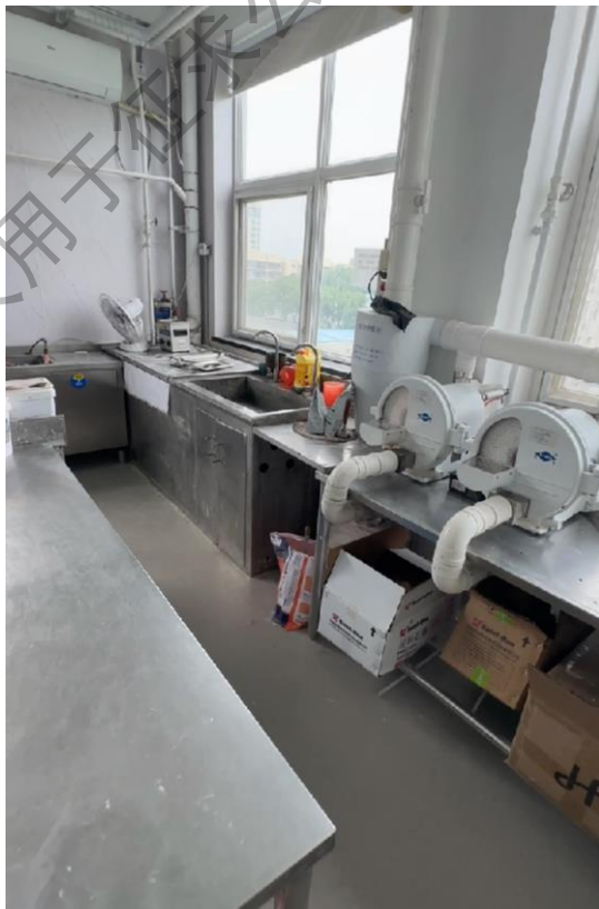
图 4-1 污水处理设施-三格沉淀池
